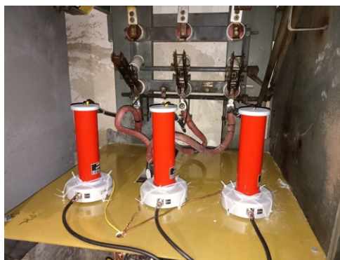
Рис. 2. Экспериментальные исследования в городской кабельной сети 10 кВ с целью выявления перенапряжений
