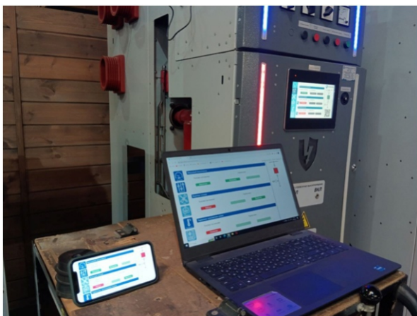
Рис. 1. Внешний вид оборудования и пультов управления
